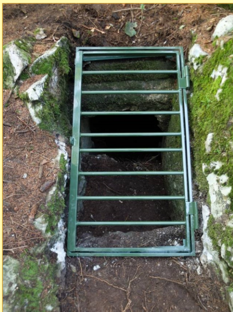
Foto 2 e 3. Grotta di Cima Paradiso, confronto del cancello d'ingresso prima e dopo l'intervento - Foto A. Ferrario
